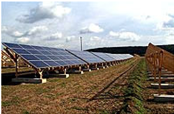
Abb. 2: Solarpark Markstetten (Quelle: Voltwerk AG)
