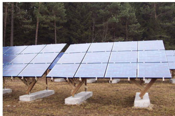
Abb. 4: Solarpark Hemau (Quelle: Voltwerk AG)
