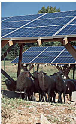
Abb. 3: Solarpark Sonnen (Quelle: Voltwerk AG)
